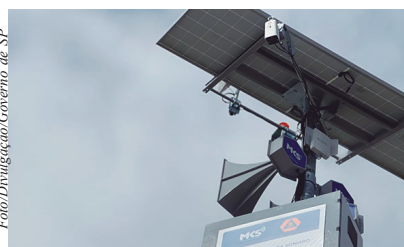
O Sistema de Sirenes de Alerta Remoto integra o conjunto de medidas preventivas adotadas pelo Governo do Estado para ampliar a segurança da população em áreas classificadas como de risco
