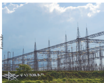
Energia - Linha de Transmissão
