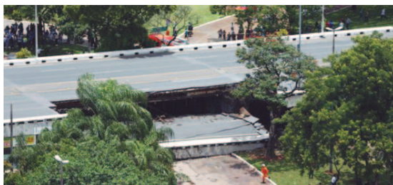
Parte do viaduto desabou na área central da capital federal
